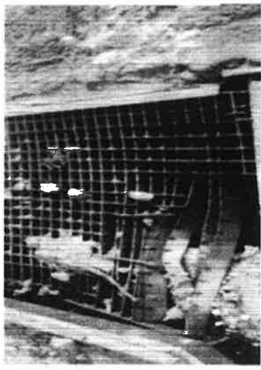
Grilles effilochées, risque de chute
